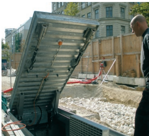
Automatisk P-anlæg, Nørre Allé, København.
