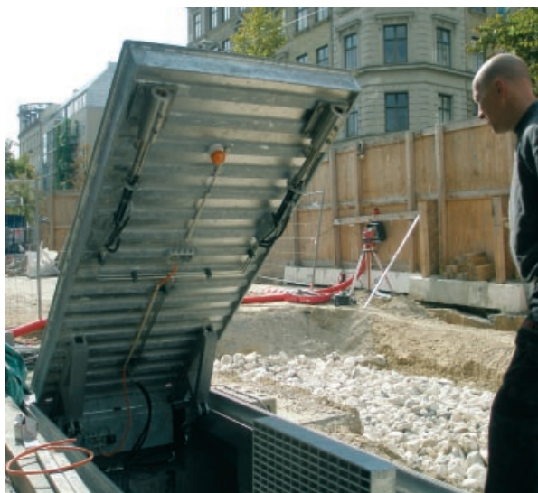
Automatisk P-anläggning, Norra Allén, Köpenhamn.
